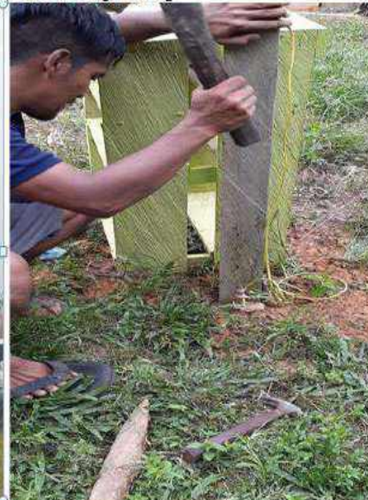
Foto: Antena grounding
