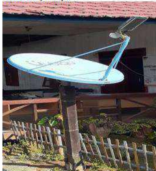
Antena Tampak Depan
