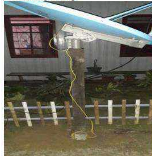
Foto: Antena grounding
